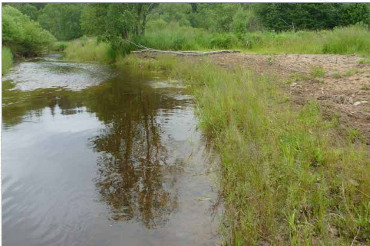
Obr. 158a. Zpevnění meandru pod elektrovodem na hlavním toku Blanice nad kolonií perlorodek. Pohled na stabilizovaný meandr (jaro 2016).
