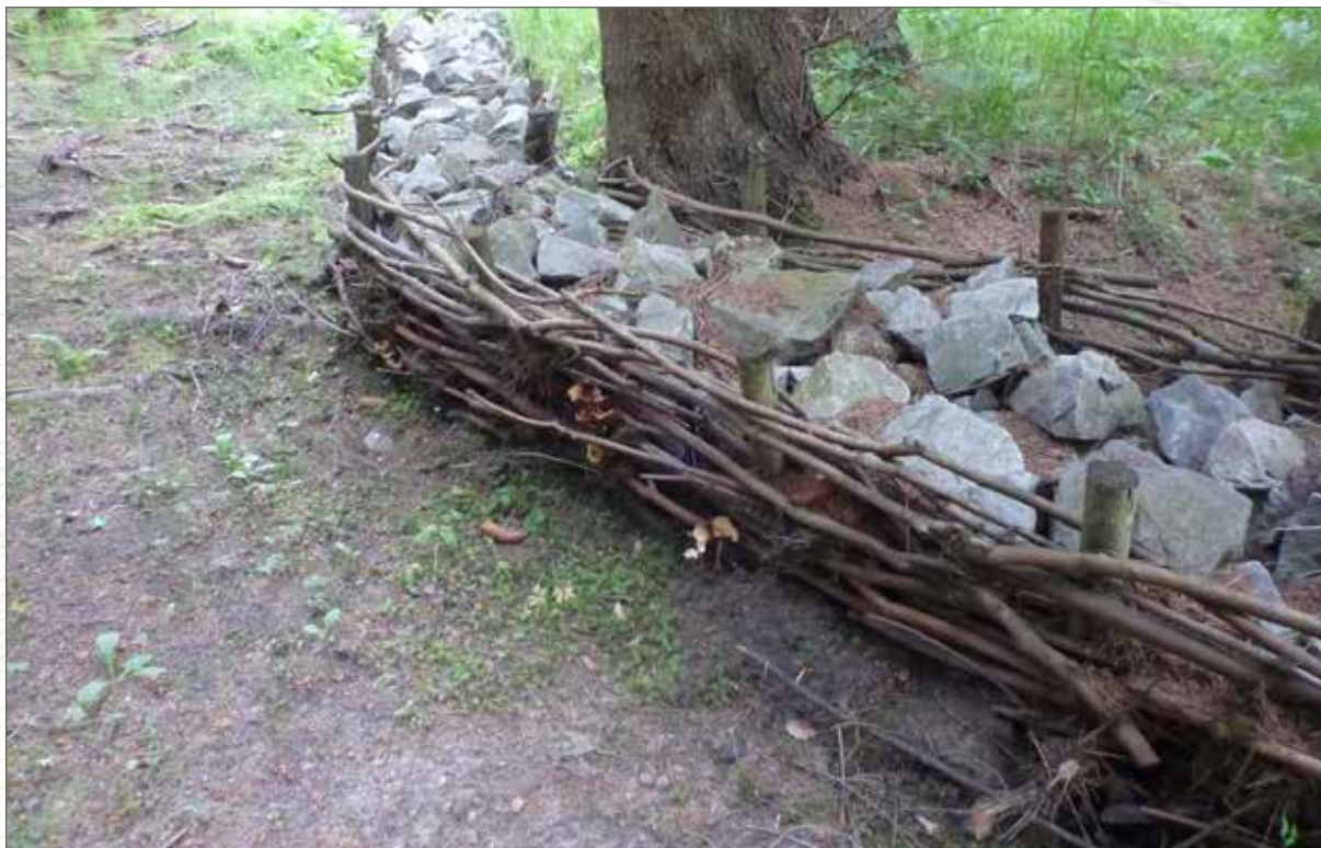
Obr. 143. Hrázka tvořená dvojitým vrbovým oplůtkem a vyplněná uvnitř lomovým kamenem. Při vyšších vodních stavech voda částečně hrázku obtéká, částečně protéká skrz. Jemnozrnné i hrubozrnné plaveniny se zachytávají před hrázkou.
