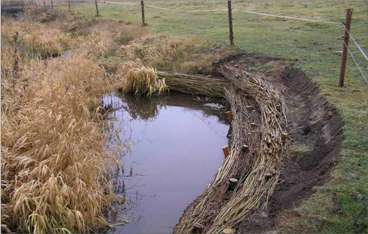
Obr. 198a. Instalaci většího množství oživených haťošterkových válců do toku podle projektu Vejmělkové a Simona (2006) realizoval v listopadu 2006 správce toku ZVHS Prachatice (dnes s. p. Povodí Vltavy).
