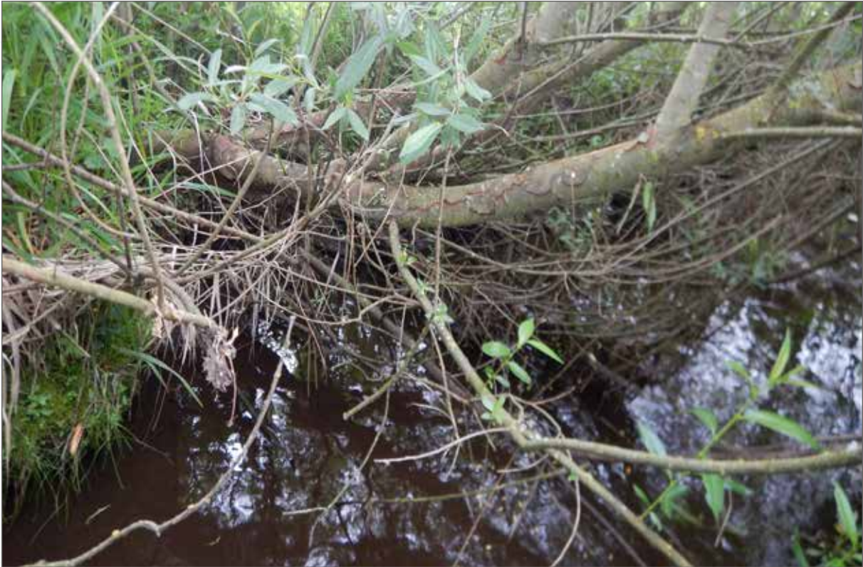
Obr. 153a. Příklad hatošterkových válců vyžadujících údržbu. Vyvrácené kmínky, zasahující do průtočného profilu, je nutno vyřezat.
