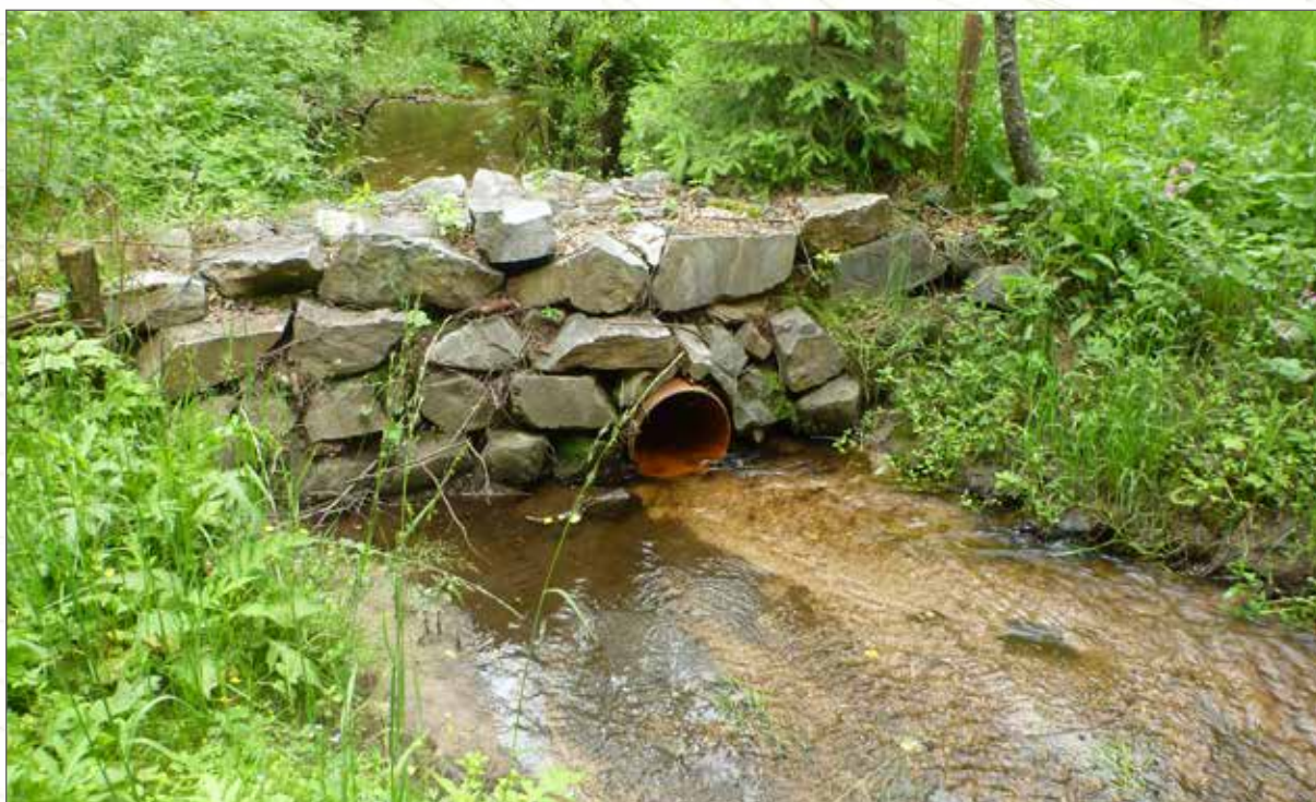
Obr. 144. Polopropustná přehrážka. Tato přehrážka je za normálního vodního stavu průtočná, v případě zvýšení průtoku ale protéká jen část určená kapacitou trubky. Nadbytečný průtok se vzedme a vyběží určeným směrem. Trubka musí být stále zavodněna a bez proudového skoku, aby netvořila migrační překážku pro pstruhy.
