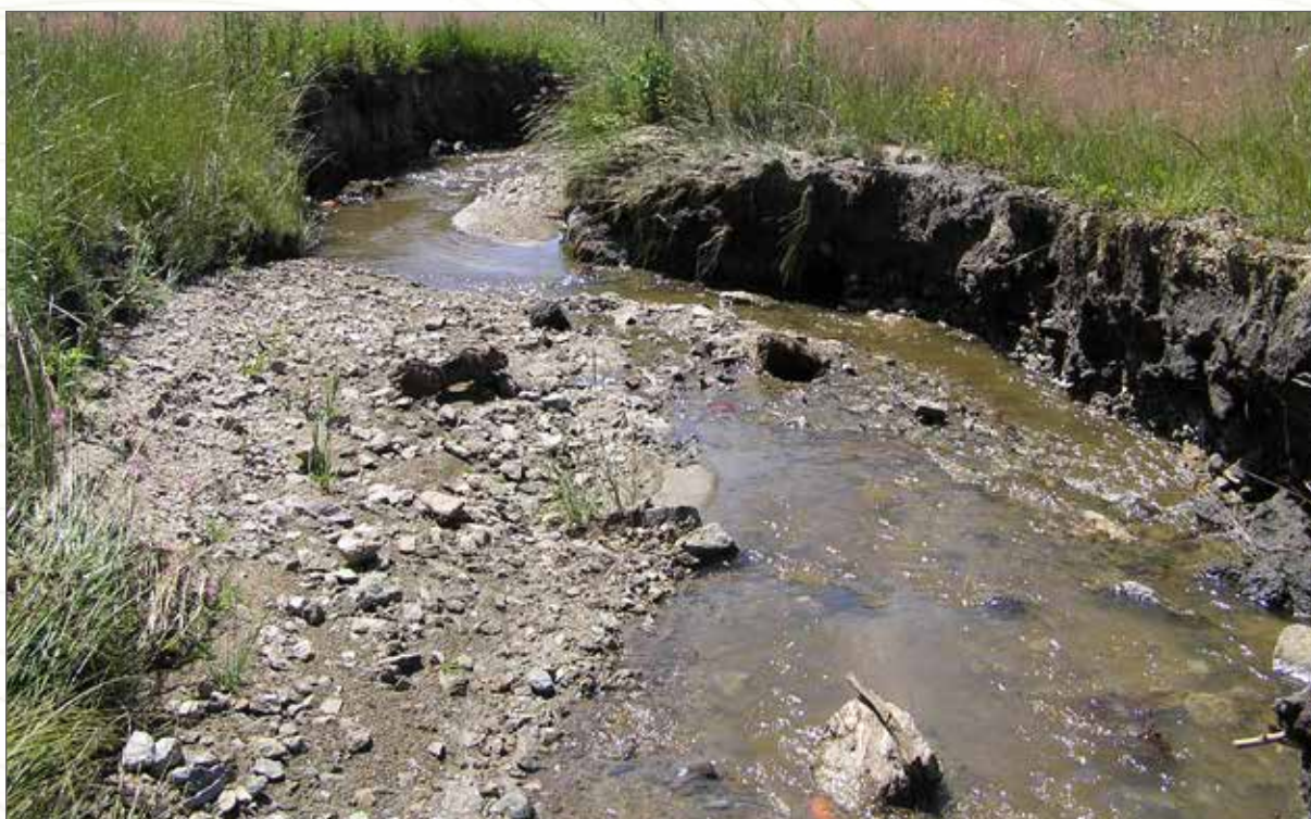
Obr. 134b. Masivní erozní procesy, nastartované zvýšenými průtoky při jarním tání na revitalizovaném Zbytinském potoce, které způsobily odnos jemnozrnného materiálu, písku i šterku do hlavního toku Blanice.
