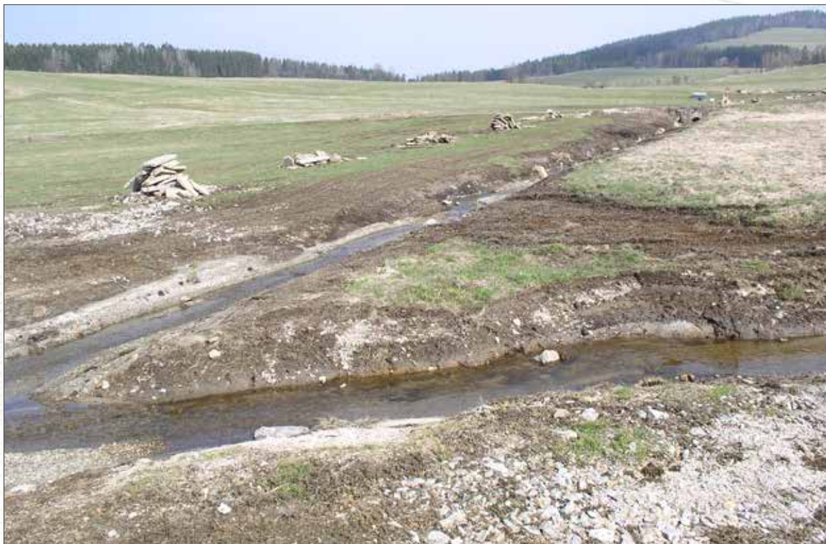
Obr. 134a. Zbytinský potok a Sviňovická strouha (ústí – vpravo) bezprostředně po revitalizaci. Vedle koryta Zbytinského potoka jsou patrné zbytky vytrhaného betonového opevnění, tok zůstal zahlouben a napřímen.
