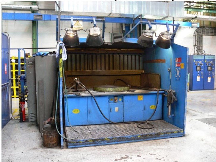
Obr. 4: Stolová kabina se suchým filtračním systémem pro záchyt TZL
