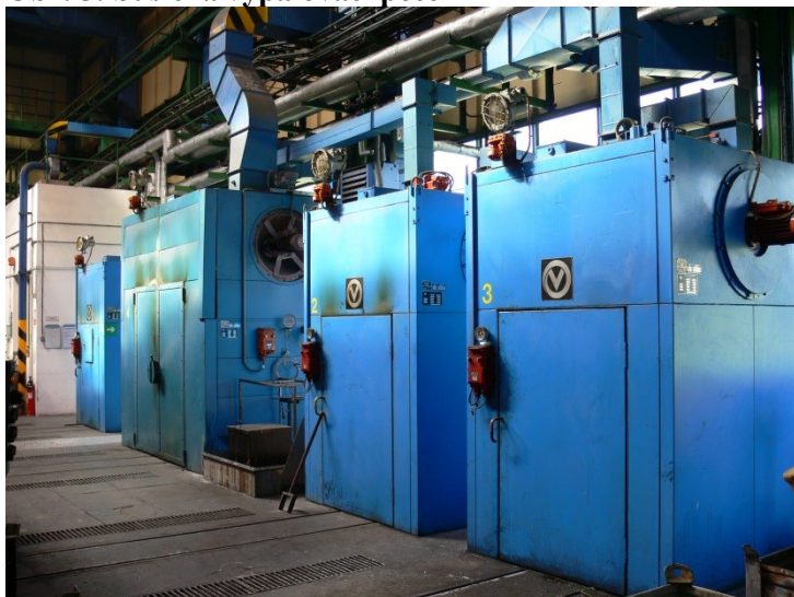
Obr. 5: Sušící a vypalovací pece
